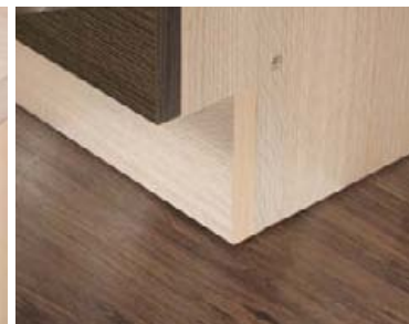
Podcinane boki szafek dolnych dla zachowania jednej linii cokołu.
